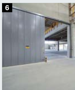
Uși culisante de protecție împotriva incendiilor
